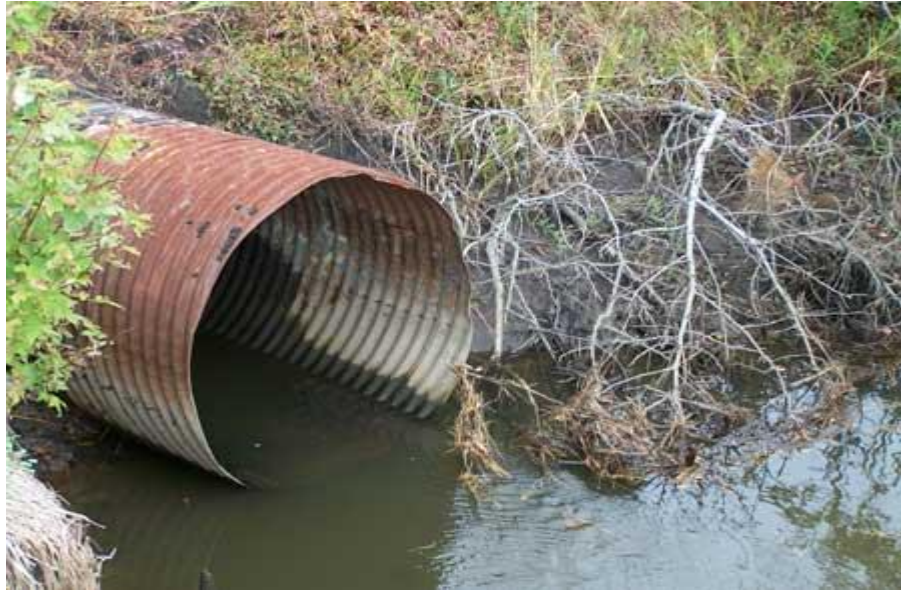
Slika 1. Ispust kućanskih otpadnih voda
