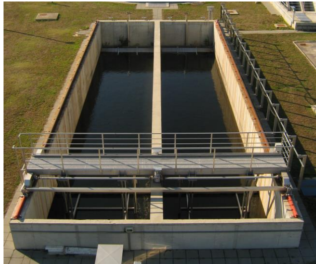
Slika 12 Naknadni taložnik uređaja za pročišćavanje otpadnih voda grada Belog Manastira
