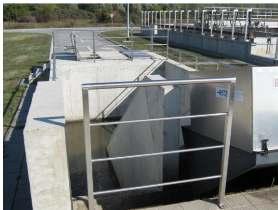
Slika 13 Crpna stanica za povrat mulja uređaja za pročišćavanje otpadnih voda grada Belog Manastira
