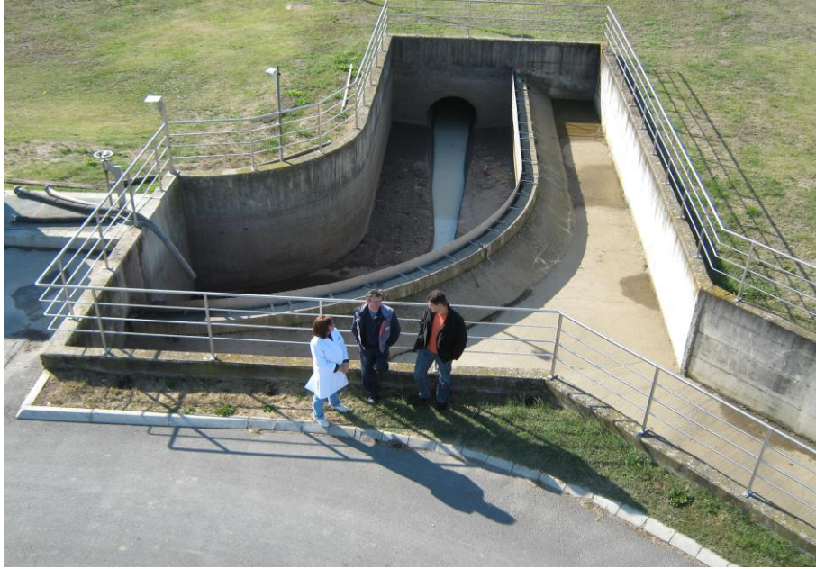
Slika 9 Oteretni prelivni kanal na uređaju za pročišćavanje otpadnih voda grada Belog Manastira
