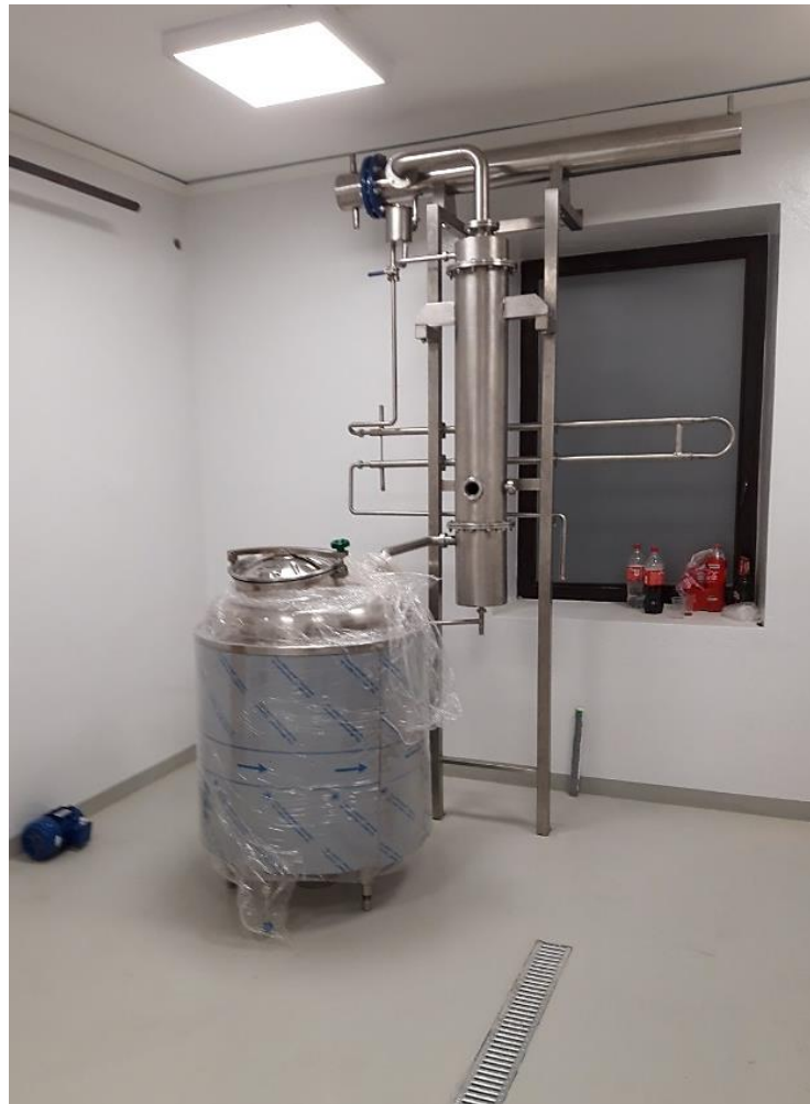
Slika 24 Instalacija destilacijskog uređaja u pogonu (Velić, 2022)
