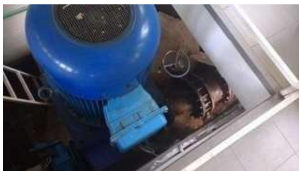
Slika 5. Crpka za dovođenje sirove vode u pogon za preradu vode za ljudsku potrošnju tvrtke Vodovod d.o.o. Slavonski Brod
