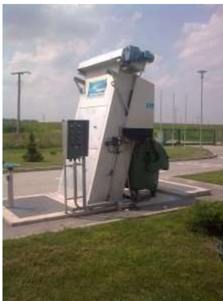
Slika 3 Automatska gruba rešetka na UPOV Koprivnica ( https://www.kcvode.hr/galerija/ )
