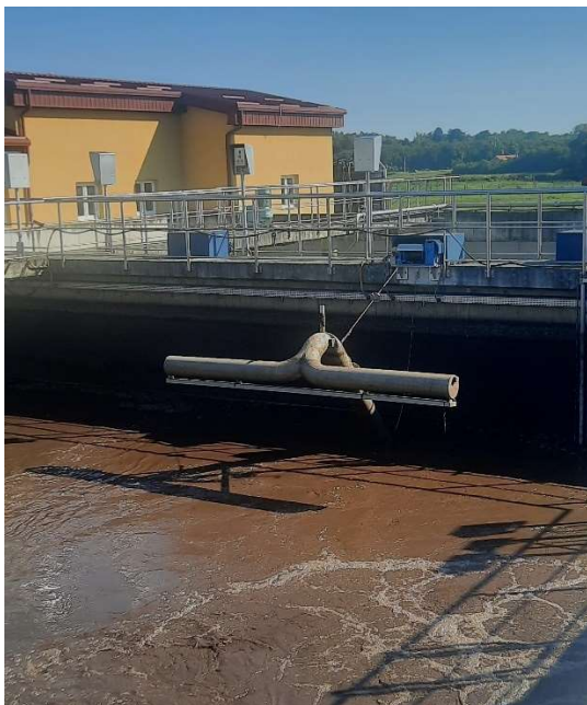
Slika 9 Uređaj za dekantiranje T - oblika na UPOV Đurđevac
