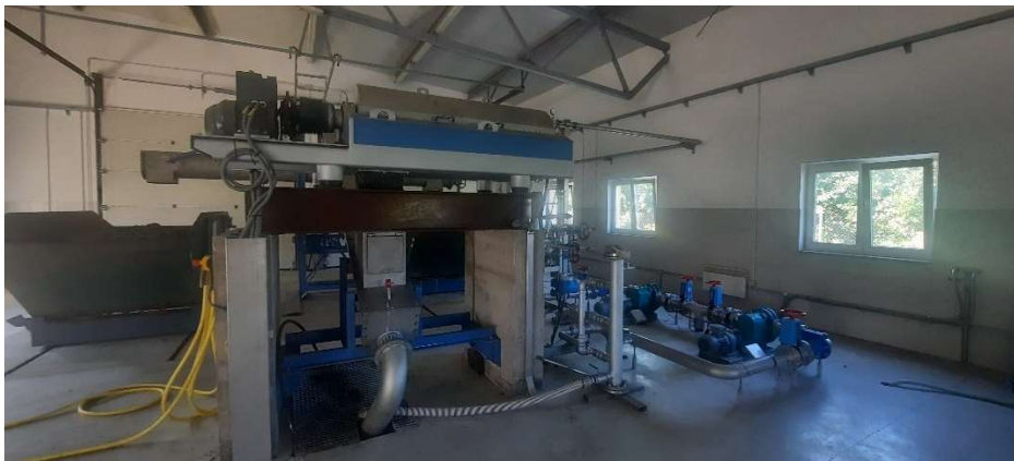
Slika 10 Postrojenje za obradu i isušivanje mulja na UPOV Đurđevac
