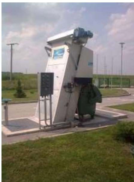
Slika 3 Automatska gruba rešetka na UPOV Koprivnica ( https://www.kcvode.hr/galerija/ )
