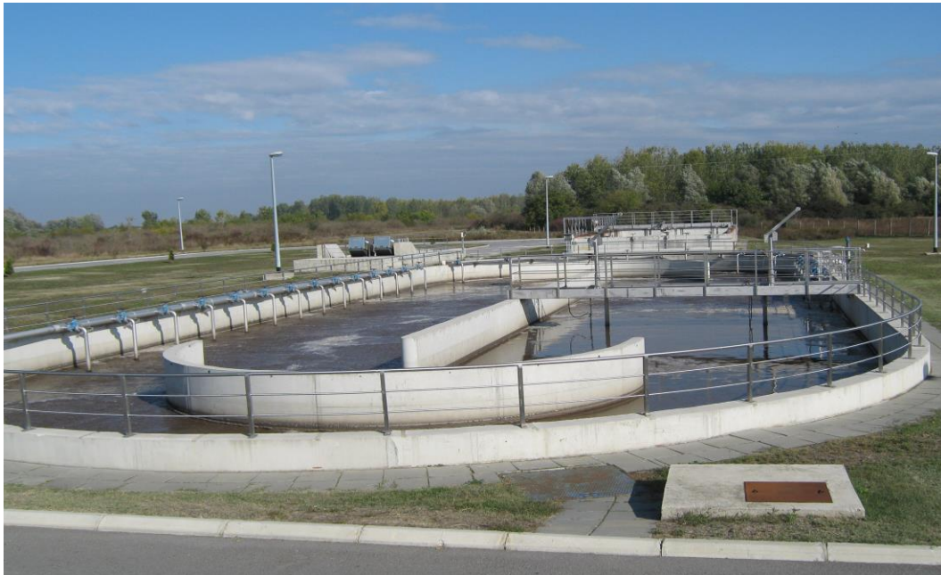
Slika 11 Bioeracijski bazen uređaja za pročišćavanje otpadnih voda grada Belog Manastira
