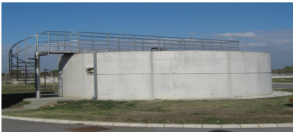
Slika 14 Zgušnjivač stabiliziranog mulja uređaja za pročišćavanje otpadnih voda grada Belog Manastira
