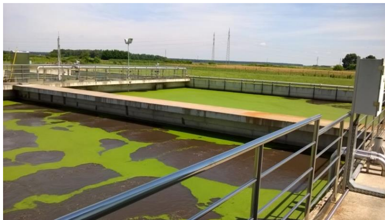
Slika 5 Aeracijski biološki bazen na UPOV Našice
