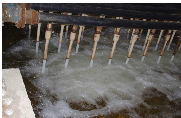
Slika 1 Aeracija sirove podzemne vode u bazenu za aeraciju ("Vodovod-Osijek d.o.o.")
