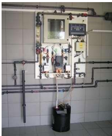
Slika 13. Uređaj za proizvodnju i doziranje klorova dioksida u pogonu tvrtke Vodovod d.o.o. Slavonski Brod
