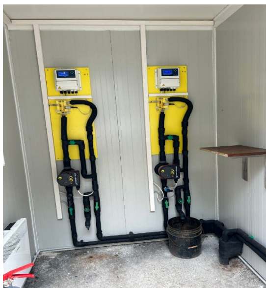
Slika 7 Stanica za dokloriranje
