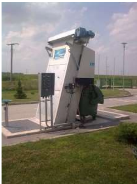
Slika 3 Automatska gruba rešetka na UPOV Koprivnica ( https://www.kcvode.hr/galerija/ )
