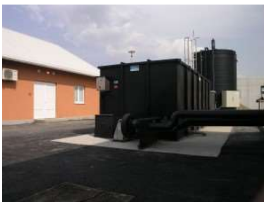
Slika 6 Biofiltar za pročišćavanje zraka na UPOV Koprivnica ( https://www.kcvode.hr/postrojenje/ )
