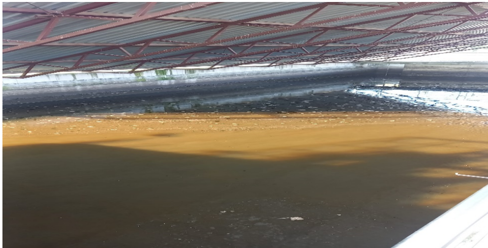
Slika 7 C-TECH bazen koji djeluje kao aeracijski sustav i sekundarni taložnik
