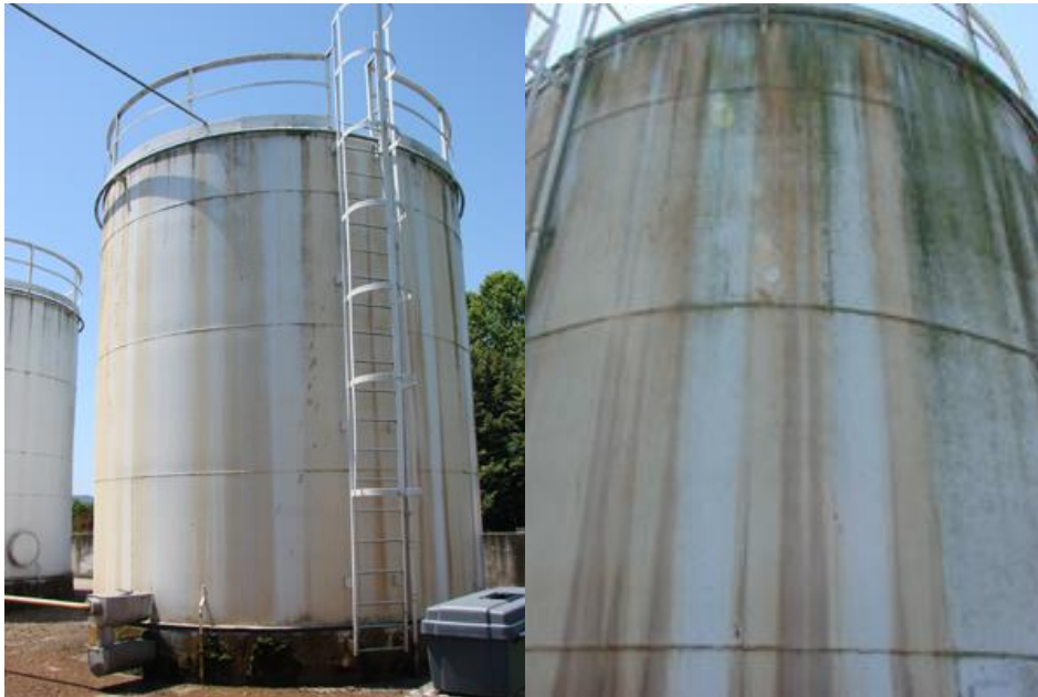
Slika 4. Korozijsko oštećenje premaza rezervoara (Izvor: https://pierre.fkit.hr/korozija/slike.php )
