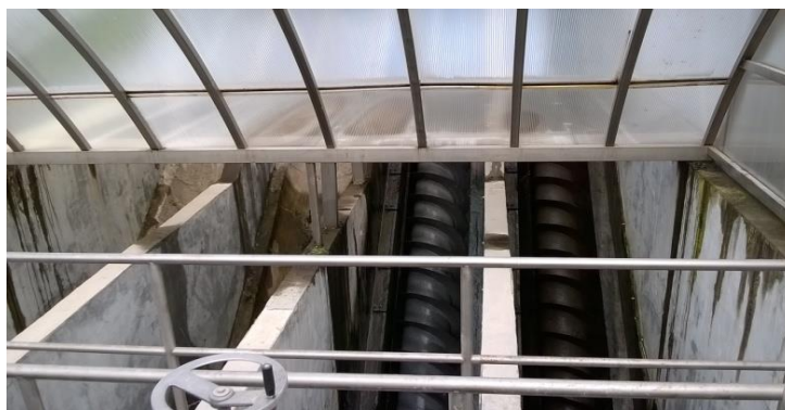
Slika 3 Arhimedove spiralne crpke ulazne crpne stanice na UPOV Našice
