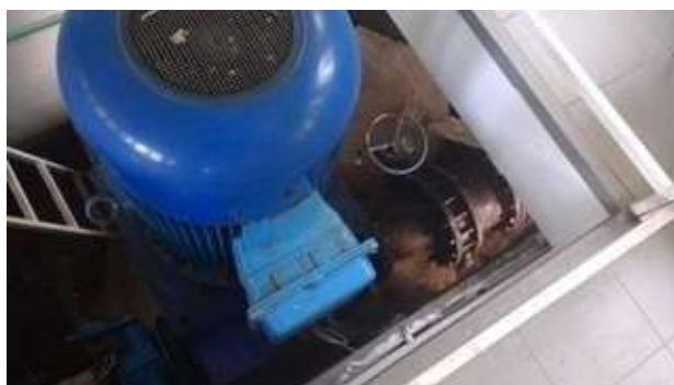
Slika 5. Crpka za dovođenje sirove vode u pogon za preradu vode za ljudsku potrošnju tvrtke Vodovod d.o.o. Slavonski Brod
