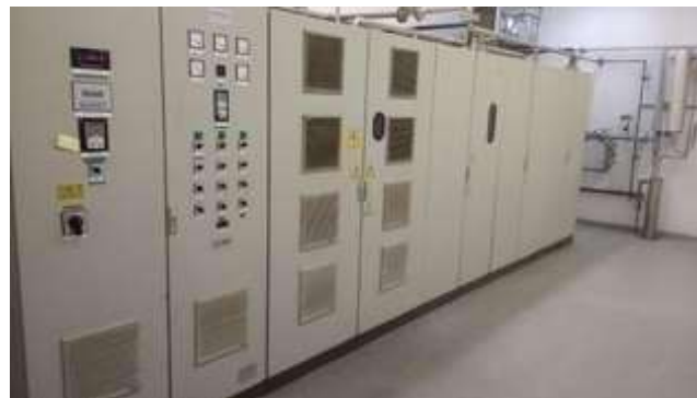
Slika 10. Ozon generator u pogonu tvrtke Vodovod d.o.o. Slavonski Brod
