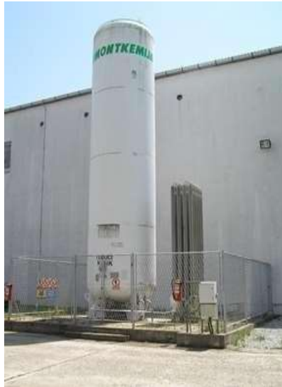
Slika 11. Spremnik tekućeg kisika u pogonu tvrtke Vodovod d.o.o. Slavonski Brod
