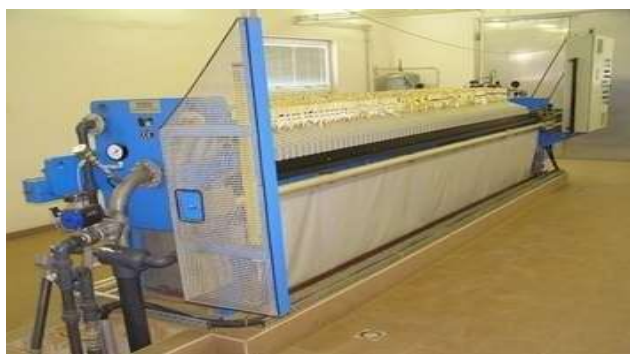
Slika 14. Filter preša u pogonu tvrtke Vodovod d.o.o. Slavonski Brod
