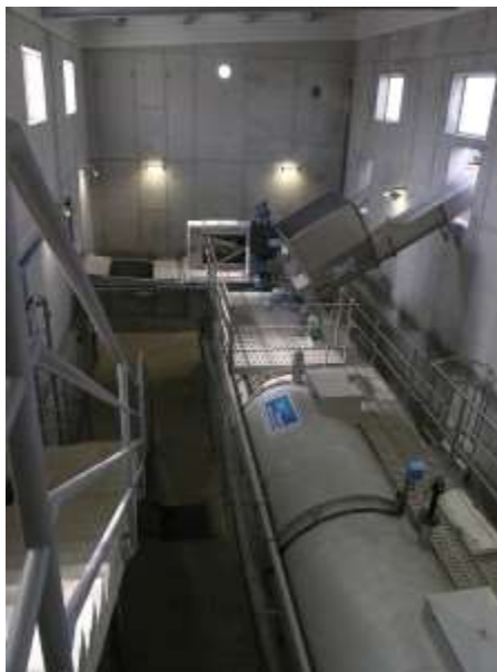
Slika 5 Fina rešetka s kombiniranim pjeskolovom – mastolovom na UPOV Koprivnica ( https://www.kcvode.hr/postrojenje/ )
