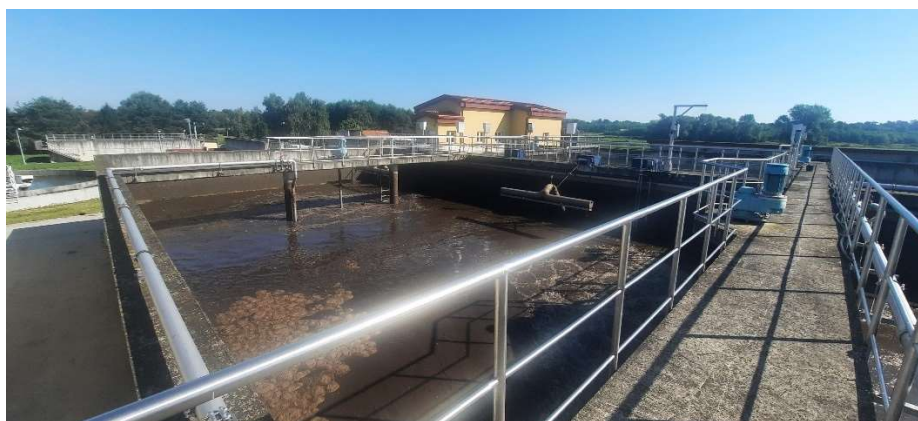
Slika 8 SBR uređaj na UPOV Đurđevac
