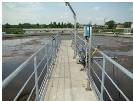
Slika 3. Aeracijski bazen u pogonu za obradu otpadne vode grada Vinkovaca Fig. 3. Aeration Plant in wastewater treatment plant of the Vinkovci town
