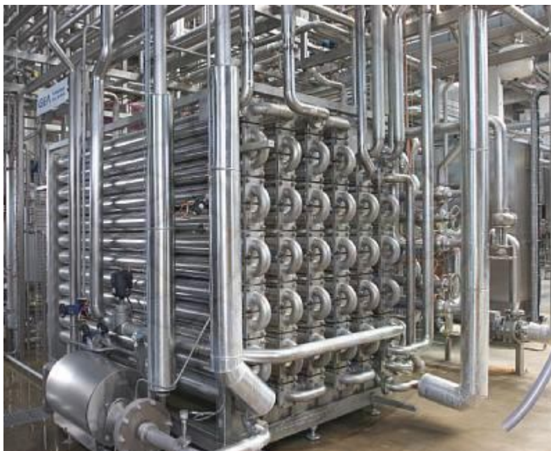
Slika 11 Izmjenjivač topline u proizvodnji mlijeka i mliječnih proizvoda ( GEA TDS GmbH, 2013)
